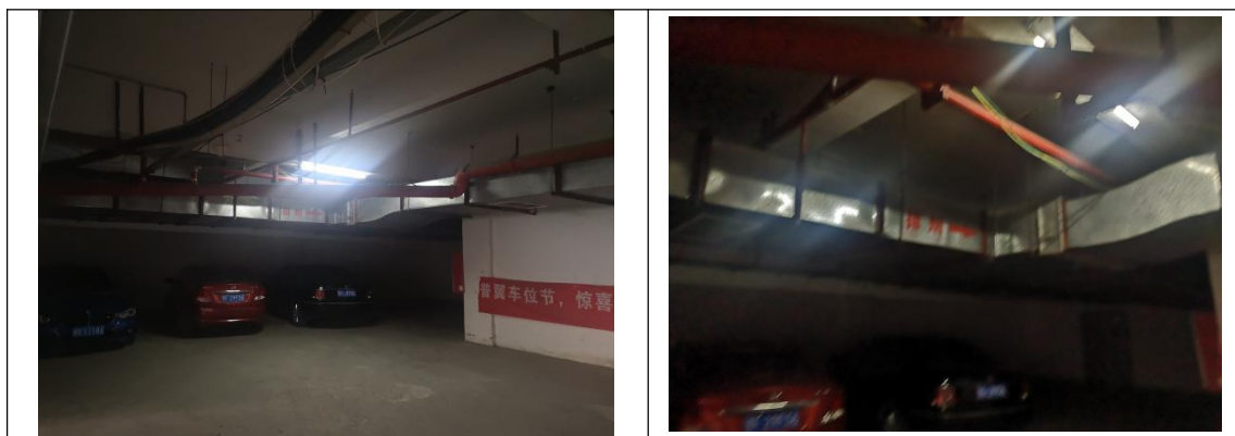
地下车库抽排风系统
